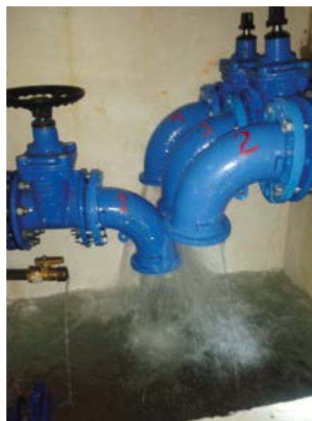
Captage d'eau potable
